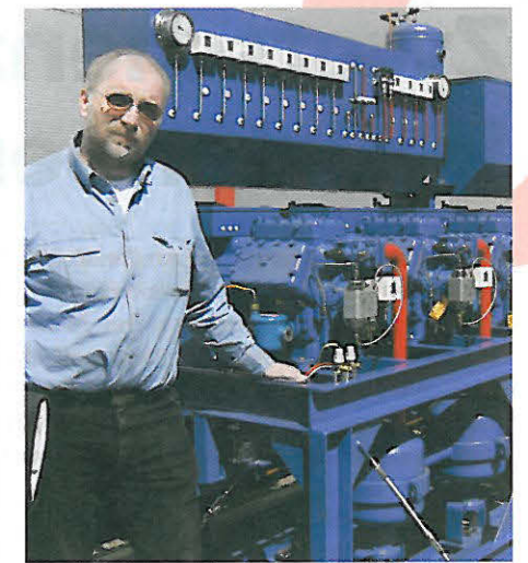
Probleme bei der Kühlung unbedingt mit dem Wartungsunternehmen besprechen, erklärt Klaus Oelrichs, Fieles/Dithmarscher Kältetechnik GmbH, Marne
